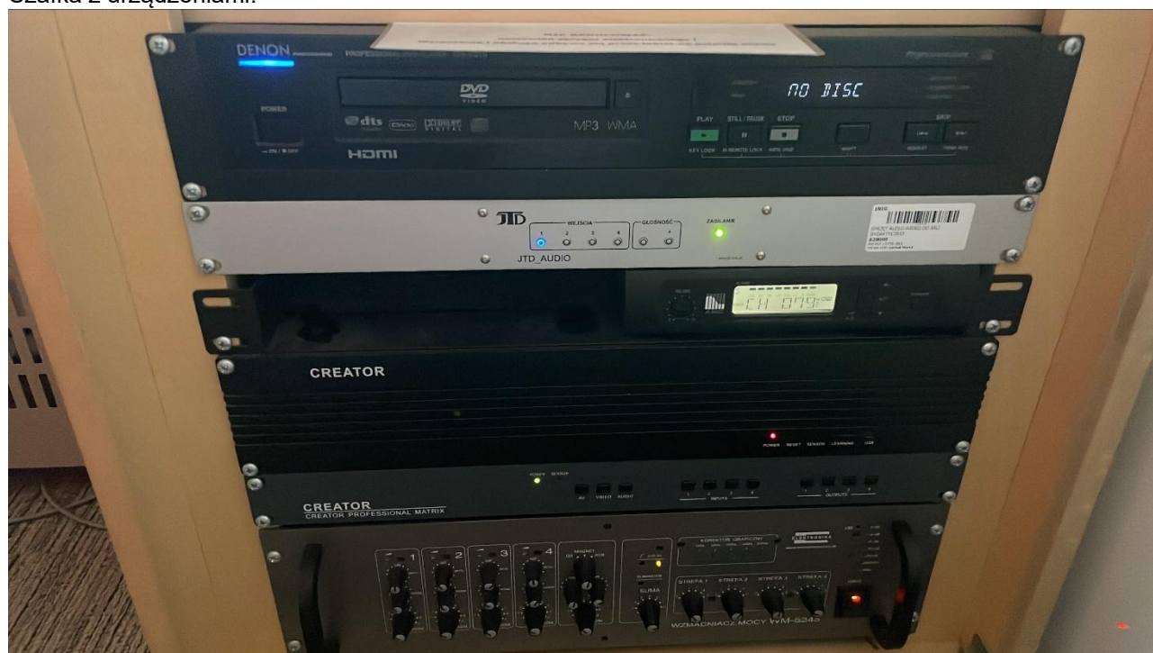
Szafka z urządzeniami.
